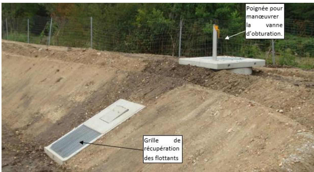
Photo d'un ouvrage pouvant être placé en sortie d'un bassin tampon aérien.
